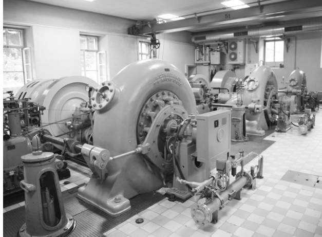
Kraftwerk Lorzentobel Maschinen Gruppe, Baar, Foto H. Gervasi 2019
